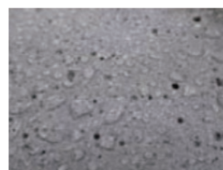
塗布面の表面の撥水状況
